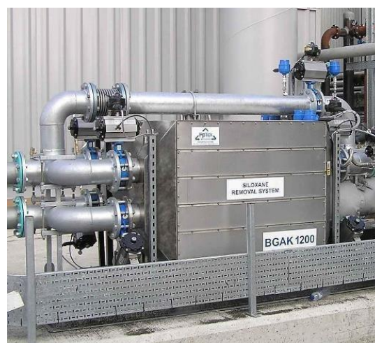
Figura 3. 16. Parker PpTek BioGas AK.
