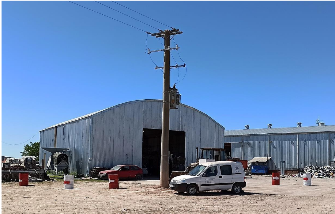
Figura 5. 16. Línea de distribución y transformación a BT. (SDF de Gualeguaychú)
