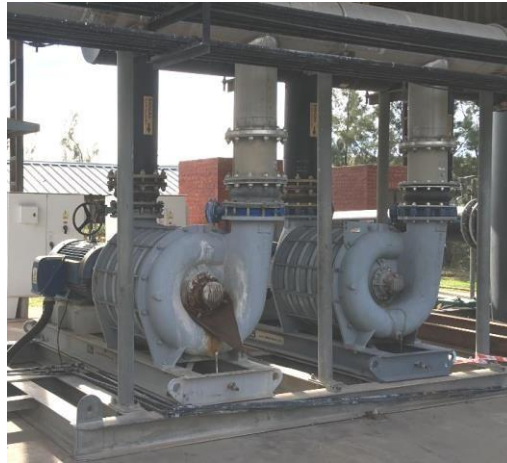
Figura 3. 11. Soladores de gas de relleno sanitario instalados en el predio de la CEAMSE. Mayo 2019.
