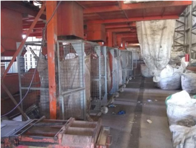
Figura 4. 9. Boca de descarga y mangas que conducen a contenedores de descarga.
