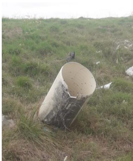
Figura 4. 22. Torre para extracción de lixiviados (Celda N° 1). Foto tomada por el INTI en noviembre de 2020.
