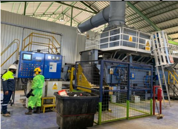
Foto 3: Vista del Incinerador con capacidad de 300 kg/h
