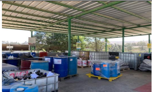
Foto 4: Área de procesamiento de luminarias (extracción de mercurio y separación de componentes)
